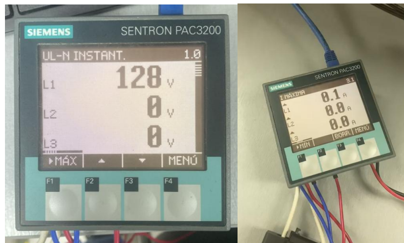
Figura 48. Sentron PAC3200 en funcionamiento.
